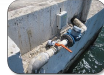
Control de aguas residuales
